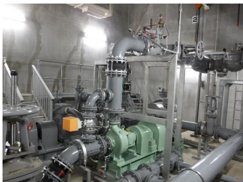
水道管の余圧を利用した小水力発電設備
